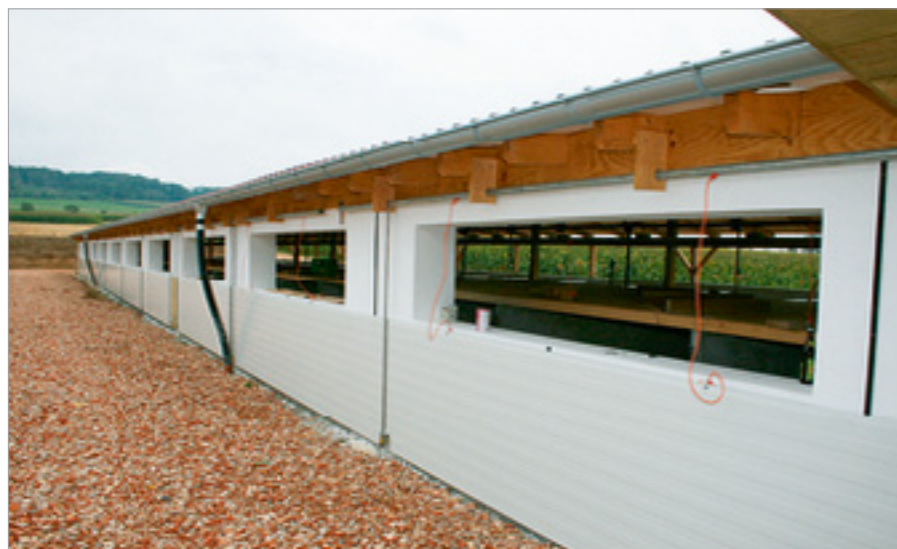
Abb. 20: Zur Stoßlüftung und bei hohen Außentemperaturen ist die Lüftungsklappe auf der Nordseite komplett abgesenkt
